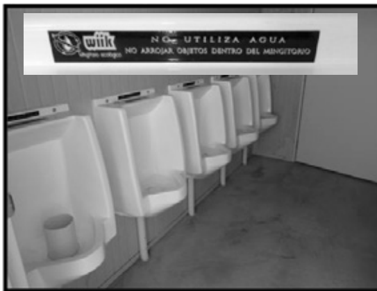
Imagen 73. Mingitorios instalados en el interior de los campamentos y oficinas.
