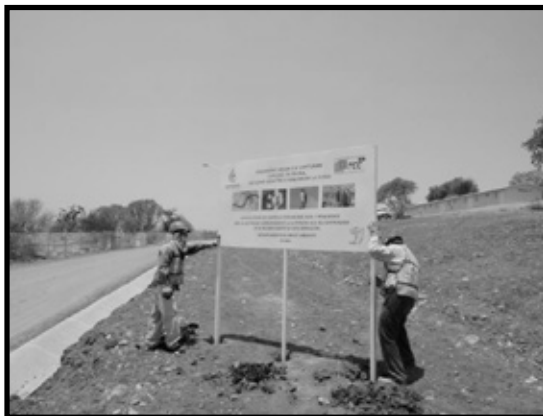
Imagen 63. Carteles informativos/prohibitivos colocados en obra para conocimiento del personal.
