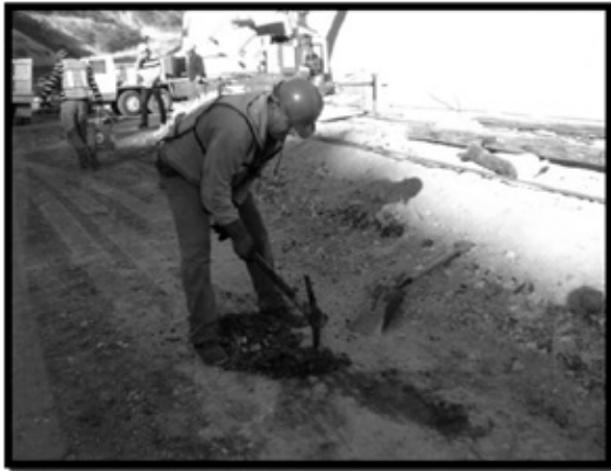
Imagen 26. Recolectión de derrames accidentales.
