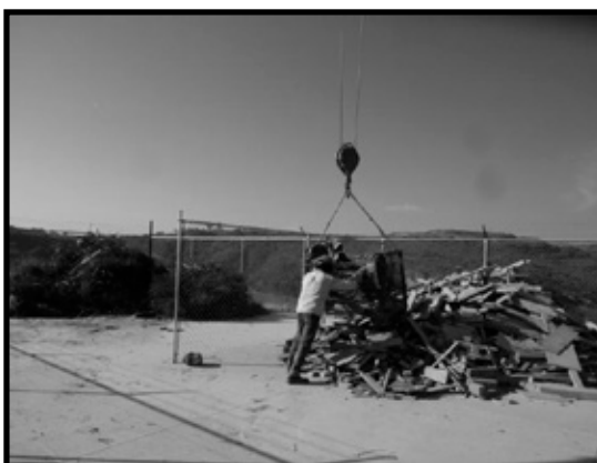
Imagen 85. Acopio de Residuos de Manejo Especial en el Almacén para RME.
