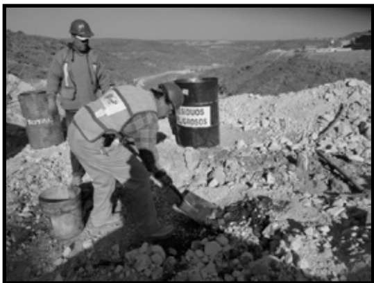
Imagen 82. Recuperación de suelo contaminado por derrames accidentales.
