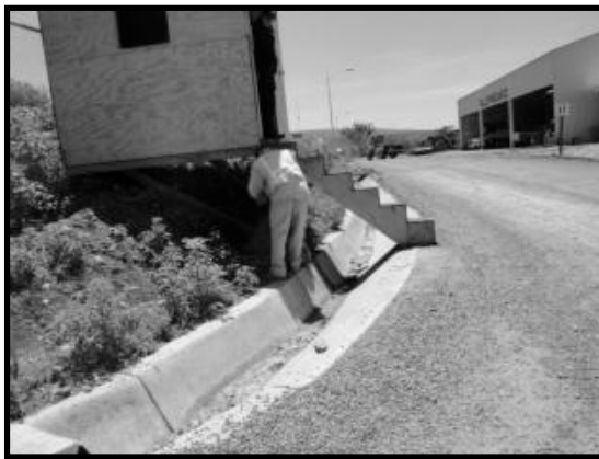
Imagen 75. Infraestructura para conducción de escurrimientos pluviales al ingreso de las oficinas.
