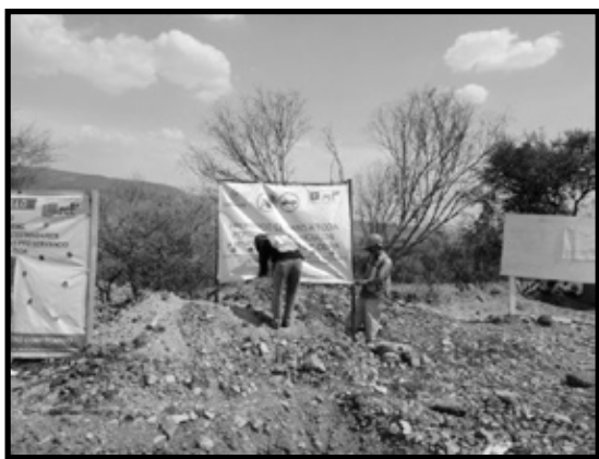
Imagen 70. Reemplazo de carteles informativos/prohibitivos colocados en obra para conocimiento del personal.
