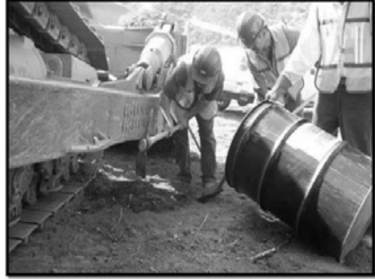
Imagen 28-A. Actividades de recuperación del suelo contaminado por derrame accidental.
