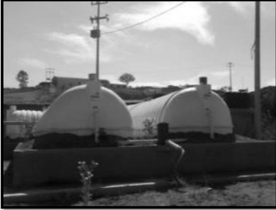
Ilustración 24. Vista de la PTAR de campamentos.
